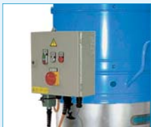
Steuerschrank für Motor, Rüttler und Füllstandssensor, sowie Fernsteuerung über Maschinenkontakt
