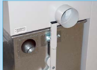
Ansaugrohr DN 140 sowie Schauglas im Sammelbehälter
